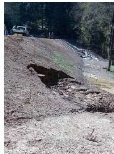
Průsak hráze rybníku v Babích dolech.
